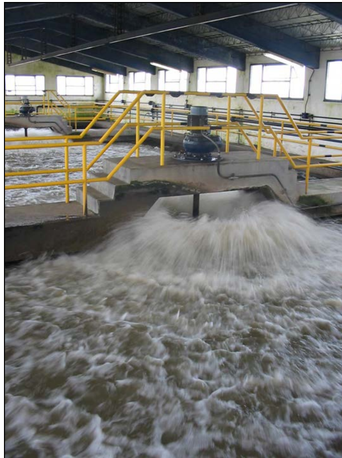
Tanque de aireación
